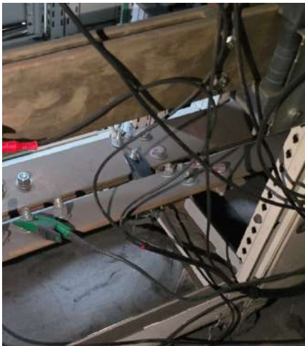
Figura 2: Conexión realizada en neutro del sistema.
