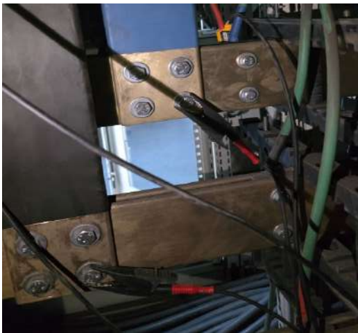
Figura 1: Conexión realizada en fases del sistema.
